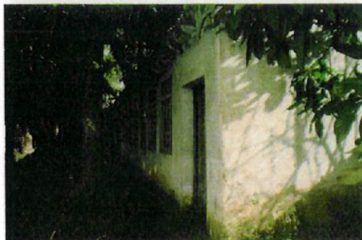
EXTERIORS NAU LATERAL AFECTADA
