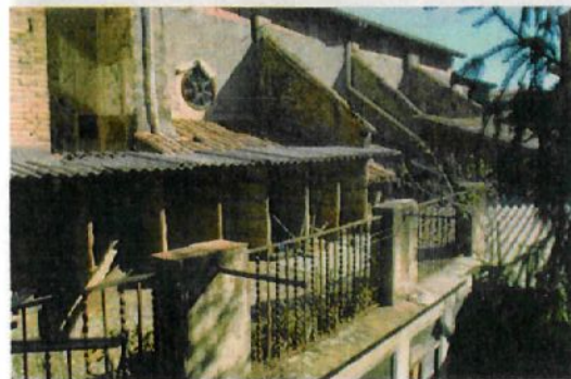
COBERTA NAU AFECTADA ADOSSADA A L'ESGLÉSIA
