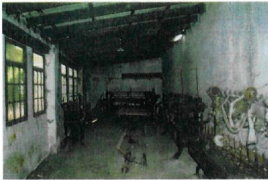
INTERIORS NAU LATERAL AFECTADA
